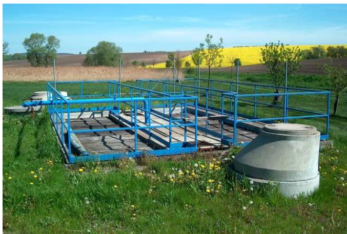
Obr. 3 Štěrbínová usazovací nádrž ČOV Dražovice
