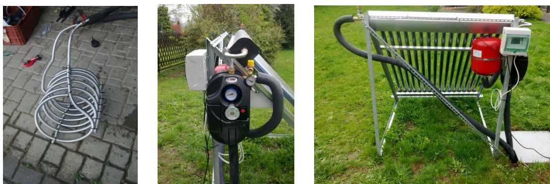
Obr. 2 Trubkový výměník, čerpací a řídicí jednotka solárního panelu, zapojení solárního panelu v septiku
