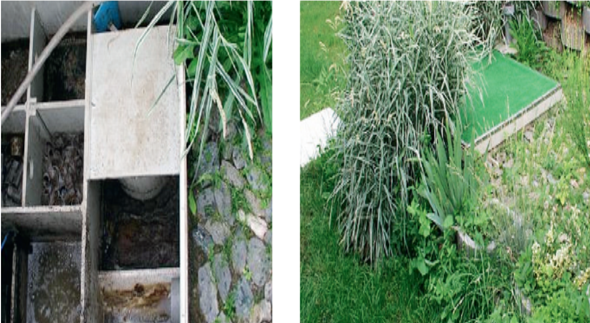
Obr. 3 Anaerobní čistírna odpadních vod ANACOMB
